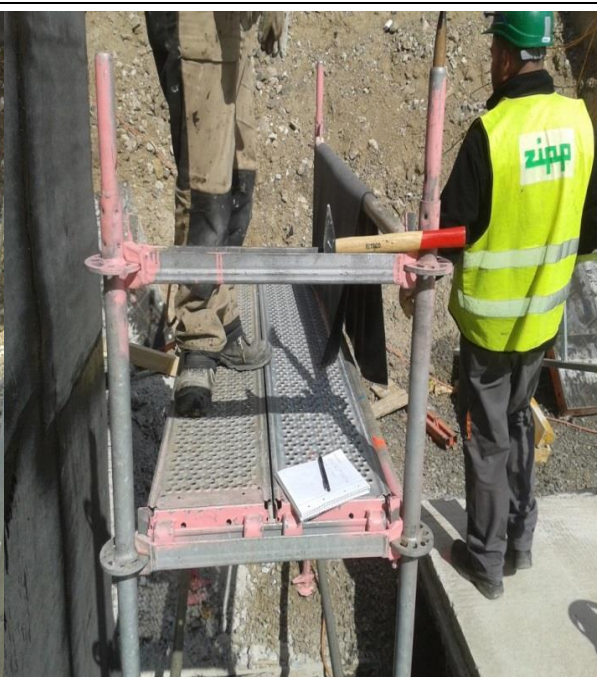
Obrázok 7 Voľné okraje pracovnej podlahy lešenia neboli vybavené jednotyčovým zábradlím so zarážkou (chýbajúce zábradlie vo výške najmenej 1 m)
